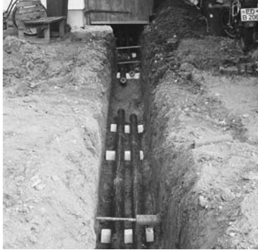
Nur wenn die Abwärme auf kurzem Weg Abnehmer findet, ist eine Biogasanlage effizient. Die Rohre sind zwar gedämmt, verlieren aber trotzdem Wärme
